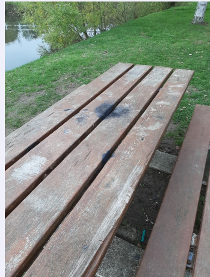
Rue du stade Dégradation par le feu de la table de pique-nique
